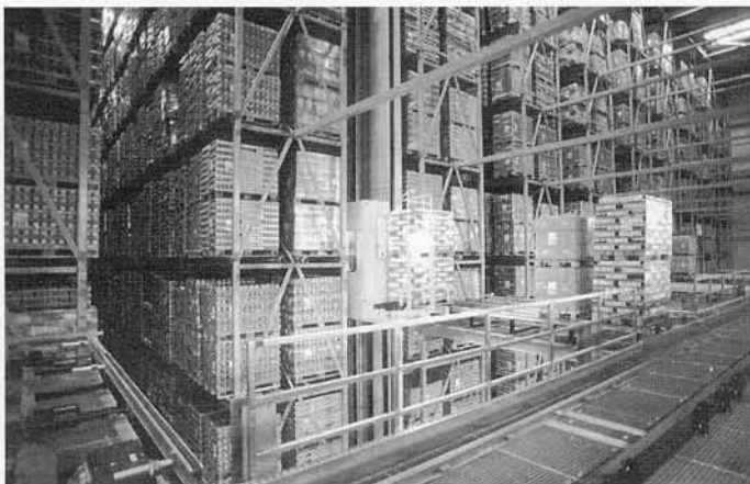
2: Diese Ansicht zeigt vom gesamten Hochregallager etwas mehr als die Hälfte. Im Vordergrund: Das RBG bei der Übernahme einer Palette vom Verteilwagen
